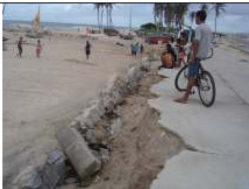
Fotografia 5 - Trecho da Avenida Costa Oeste em processo de degradação por ter sido instalado em área de domínio das marés e em uma faixa de praia submetida a processo erosivo acelerado (Fonte: Projeto Orla, fevereiro de 2006).
