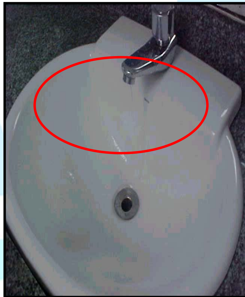
Foto 6: torneira sem uso com registro aberto
